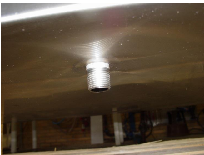
Afløb på ismaskine. Ismaskinen er set nedefra.
