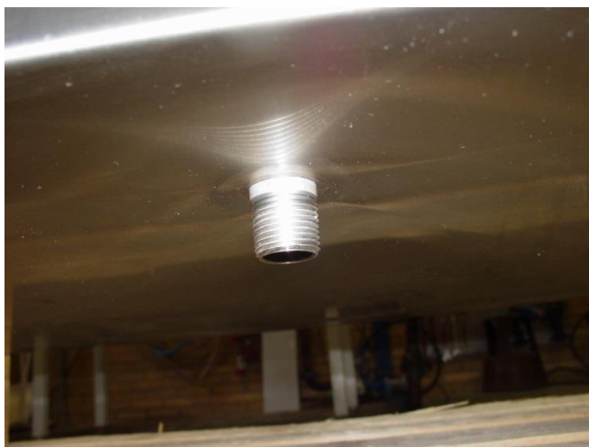
Opróżnianie wytwornicy lodu. Widok wytwornicy lodu od spodu.
